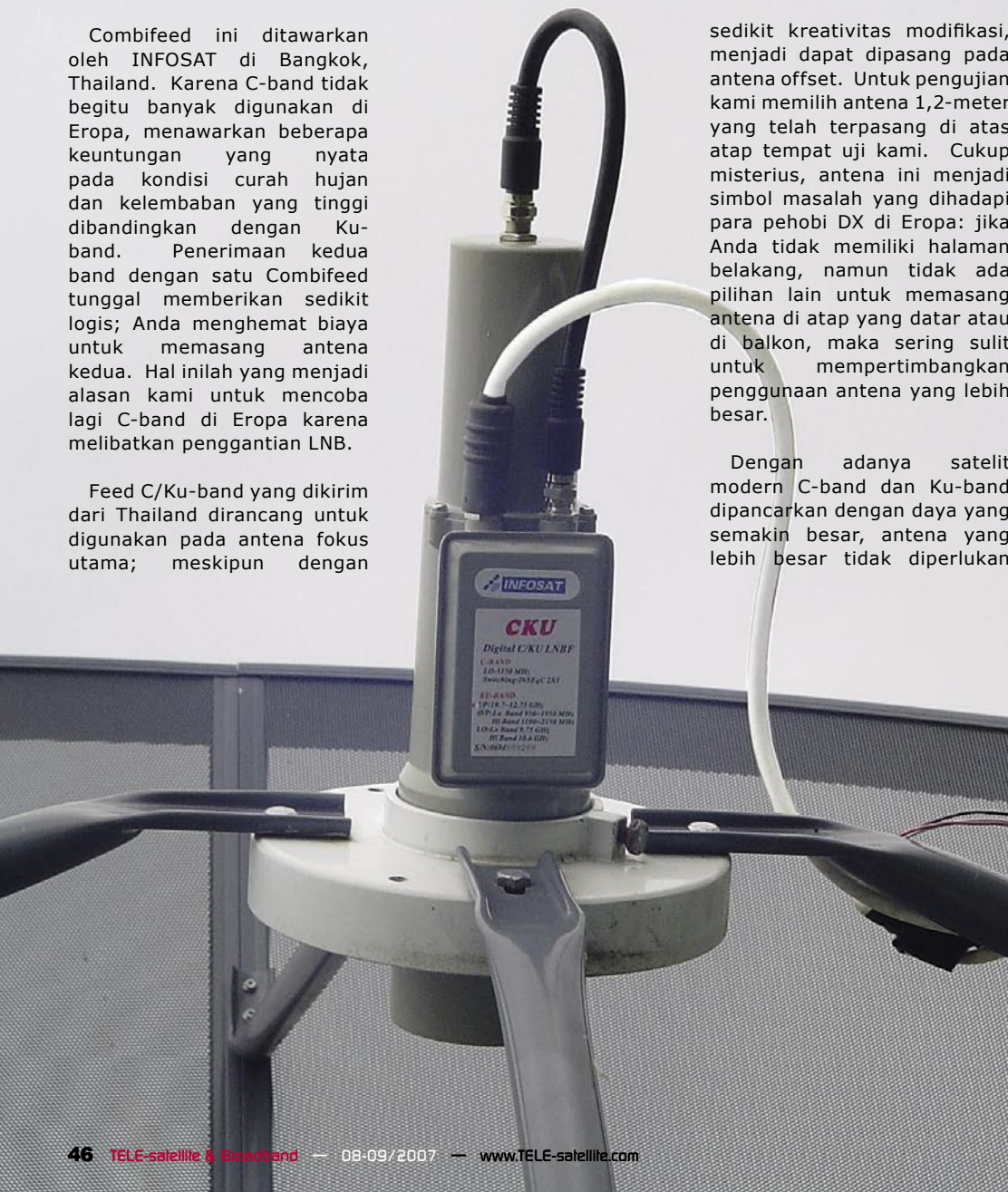
◀ LNB C/Ku dari INFOSAT terlihat dipasang pada antena parabola 1,8m.
